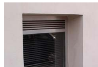
Een ventilatierooster zorgt voor de dagelijkse luchtverversing.
